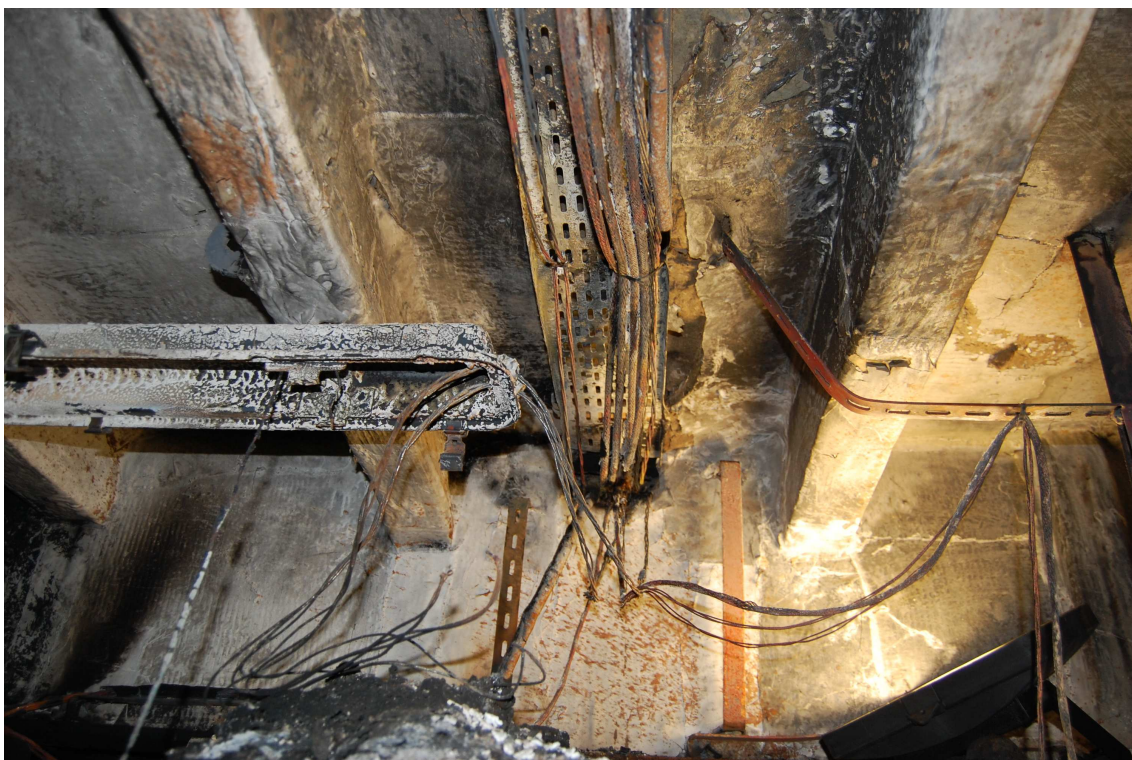
Foto: Dansk Brand- og sikringsteknisk Institut
